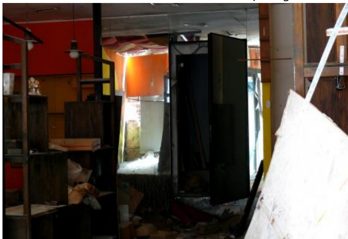
L'interno di un negozio del centro storico dell'Aquila, tutto è rimasto fermo dalle 3.32 di due anni fa
